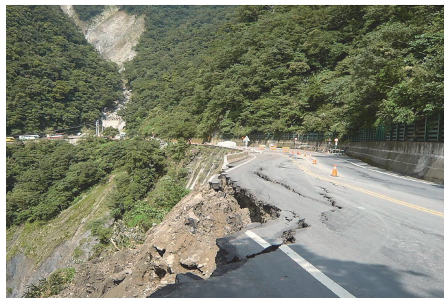
圖 9 台 9 線 115.8K 路徑垂直裂隙 (date: 2011/10/27) Fig.9 Vertical crack along the roadway at 115.8K of Route 9
