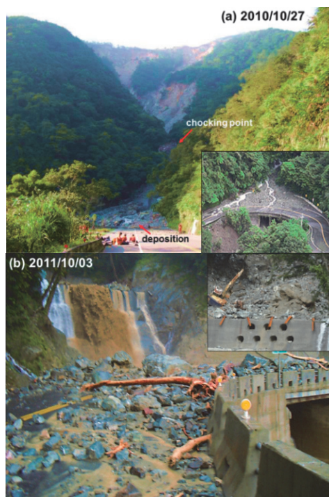
圖 6 台 9 線 115.9K 大坑橋土石堵塞 (a) 梅姬颱風後; (b) 奈格颱風後 (photos : Directorate General of Highways, M.O.T.C.)
